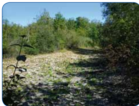
Mare asséchée lors des travaux de remise en état des écluses de la Seine sur le bief de Jaulnes (réserve naturelle de la Bassée, automne 2010)
