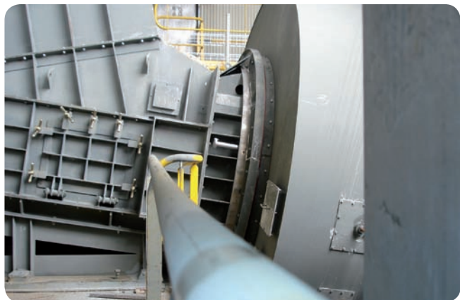
> Four d'incinération des déchets ménagers
